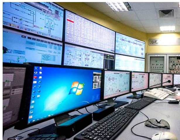
Рис. 7. Общий вид БЩУ современной мощной ТЭС [15]
