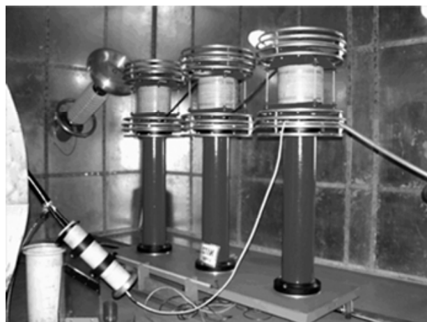
Рис. 5. Участок испытательного поля с высоковольтным фильтром и кабельным вводом
