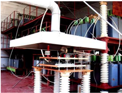
Рис. 1. Внешний вид мощного ГТМ на энергию в 1 МДж (на переднем плане находится рабочий стол с трехэлектродным воздушным разрядником F_1 , двухэлектродным воздушным разрядником F_2 и системой воздушной вытяжки, а на заднем плане – генераторы ГИТ-А и ГИТ-С для создания соответственно А- и С- компонент тока искусственной молнии)
