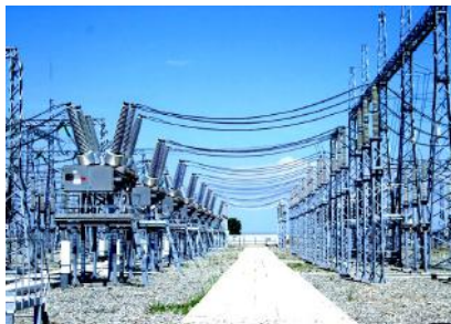
Рис. 13. Внешний вид оборудования современной мощной подстанции, преобразующей электроэнергию в соответствии с требованиями ее различных потребителей [13, 18]
