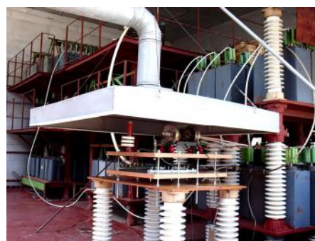
Рис. 11. Внешний вид уникального генератора тока искусственной молнии на запасаемую энергию 1 МДж разработки НИПКИ "Молния" НТУ "ХПИ" 2007 года [75]
