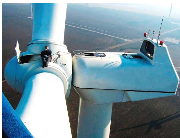
Рис. 5. Редкое фотоизображение момента техобслуживания на высоте около 70 м лопастей и ротора турбины современной горизонтально-осевой трехлопастной ВЭУ установленной мощностью до 1500 кВт сухопутного базирования [11]
