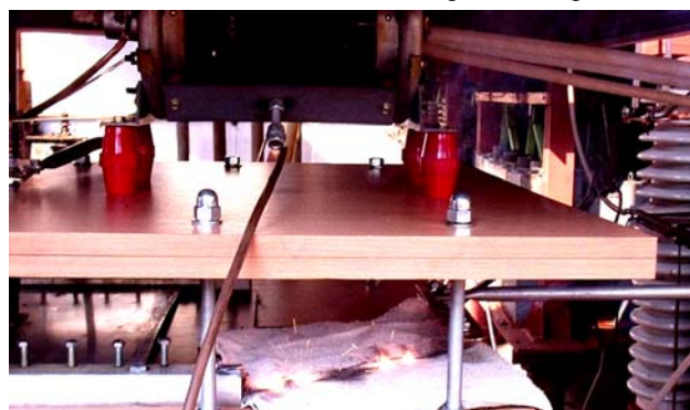
Рис. 3. Внешний вид рабочего стола мощного высоковольтного генератора ГИТ-С и теплового состояния оцинкованного стального провода ( r_0=0,8 мм; l_0=320 мм; \Delta_0=5 мкм; S_0=2,01 мм 2 ) с четырьмя «горячими» квантованными зонами шириной около \Delta z=7 мм и двумя «холодными» продольными участками (перешейками) шириной около 27 мм после воздействия на исследуемый провод аperiodического импульса тока i_0(t) временной формы t_m/\tau_p=9 мс/160 мс большой плотности ( I_{0m} \approx -745 А; |\delta_{0m}|=0,37 кА/мм 2 ; n_{0m}=9 ) [9]
