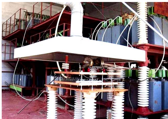
Рис. 2. Общий вид высоковольтной силовоточной испытательной установки типа УИТОМ-1 (разработчик – НИПКИ «Молния» НТУ «ХПИ»), моделирующей на ИО металлической панели топливного бака отечественного самолета прямое воздействие основных компонент тока искусственной молнии (на переднем плане находится рабочий стол с трехэлектродным управляемым воздушным коммутатором на электрическое напряжение \pm 50 кВ и системой воздушной вытяжки, а на заднем плане – мощные высоковольтные генераторы ГИТ-А, ГИТ-Д, ГИТ-В, ГИТ-С и ГИТ-С*) [5, 6]
