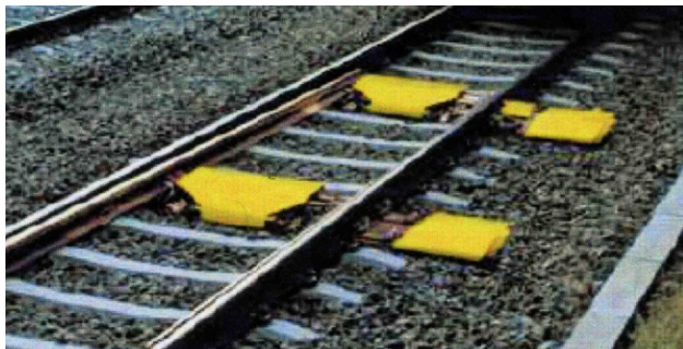
Рис. 1. Загальний вигляд стрілочного переводу EBI Switch 2000
