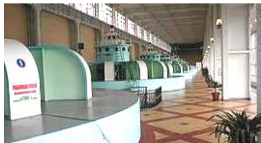
Рис. 11. Современный вид гидротурбинного зала Днепровской ГЭС с установленной мощностью 1548 МВт [15]
