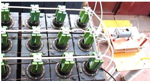
Рис. 2. Внешний вид фрагмента зарядно-разрядных цепей мощного ЕНЭ одномодульного исполнения на номинальное напряжение \pm 50 кВ и номинальную запасаемую электрическую энергию W_n=420 кДж с высоковольтными импульсными конденсаторами типа ИК-50-3 и установленными на их высоковольтных выводах защитными постоянными графито-керамическими резисторами типа ТВО-60-24 Ом [10]
