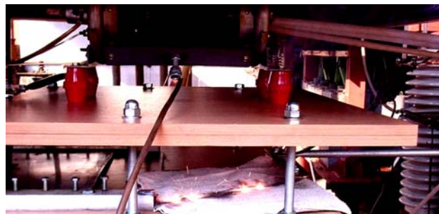
Рис. 4. Внешний вид рабочего стола генератора ГИТ-5С и теплового состояния оцинкованного стального провода ( r_0=0,8 мм; l_0=320 мм; \Delta_0=5 мкм; S_0=2,01 мм 2 ) с четырьмя "горячими" (зонами ВЭП шириной \Delta z_{nc}=7 мм) и двумя "холодными" внутренними (шириной \Delta z_{nxc}=26,9 мм) продольными участками после очередного воздействия на него аперiodического импульса тока i_0(t) временной формы 9 мс/576 мс большой плотности ( I_{0m}=-745 А; |\delta_{0m}|=0,37 кА/мм 2 ; n=9 ; остальные пять "горячих" и восемь "холодных" продольных участков исследуемого оцинкованного стального провода подверглись полной сублимации) [6, 17]
