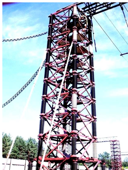
Рис. 6. Общий вид созданной и установленной на существующей изоляционной опоре нагрузочной емкости C_H \approx 13,3 нФ на номинальное импульсное напряжение 3 МВ, примененной в разрядной цепи описываемого ГКИН
